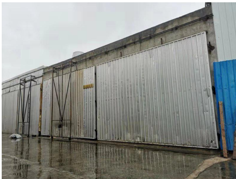
图 4-1 固废治理设施图
